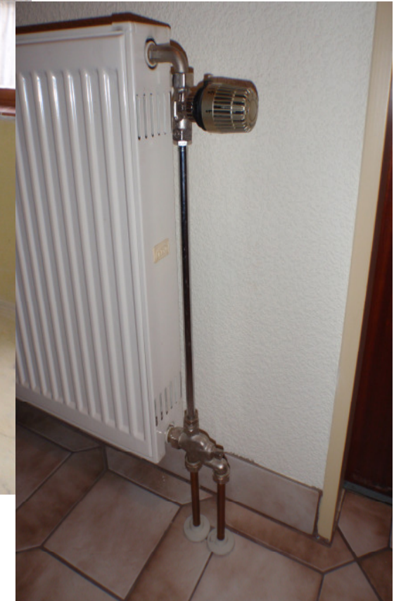
Das vorhandene Heizsystem wird weiter genutzt
